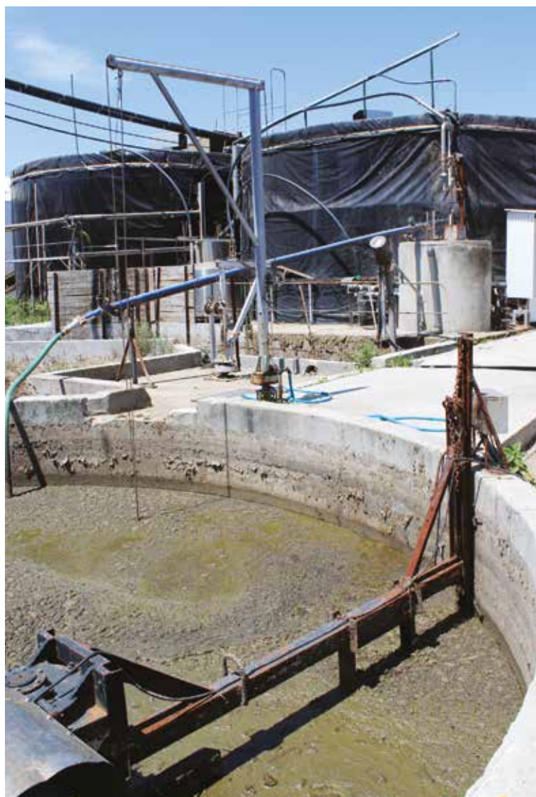
Fossa de receção do chorume e biodegestores da unidade de biogás
